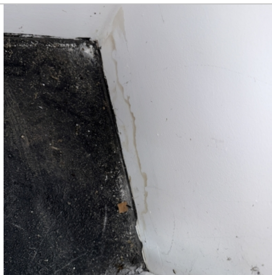
Foto: Vlhkostní poruchy v garáži
