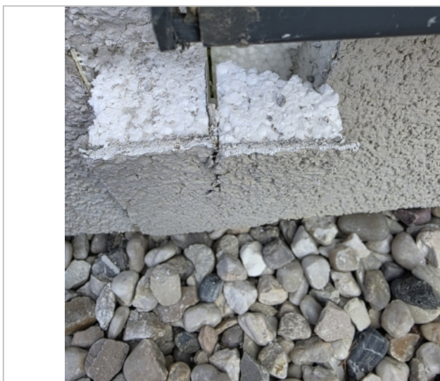
Foto: Sonda v místě trhliny
