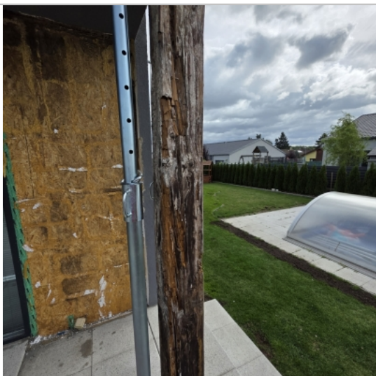
Foto: Masivní degradace dřevěné konstrukce
