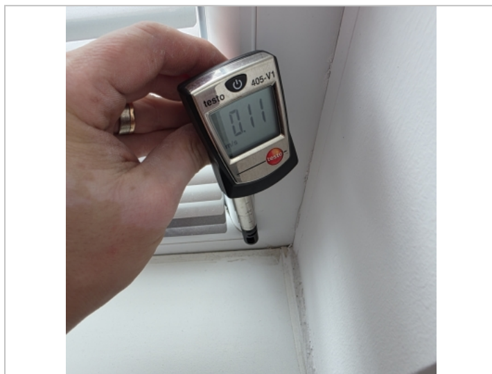
Foto: Netěsní zasklívací spára
