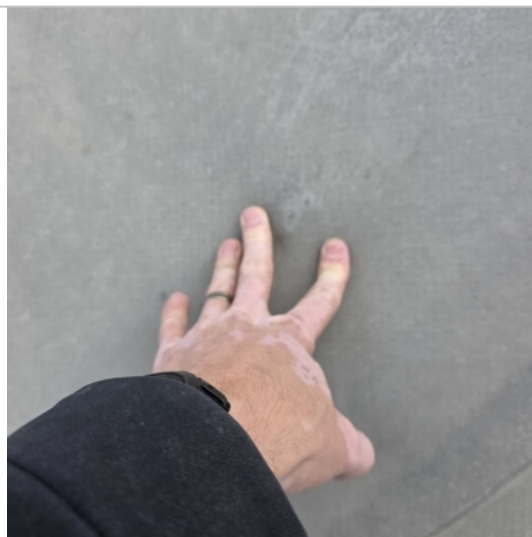
Foto: Vystupující kotvení střechy
