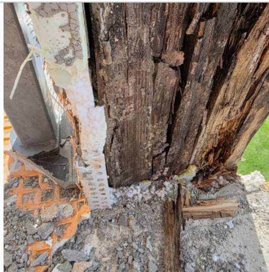
Foto: Masivní degradace dřevěné konstrukce
