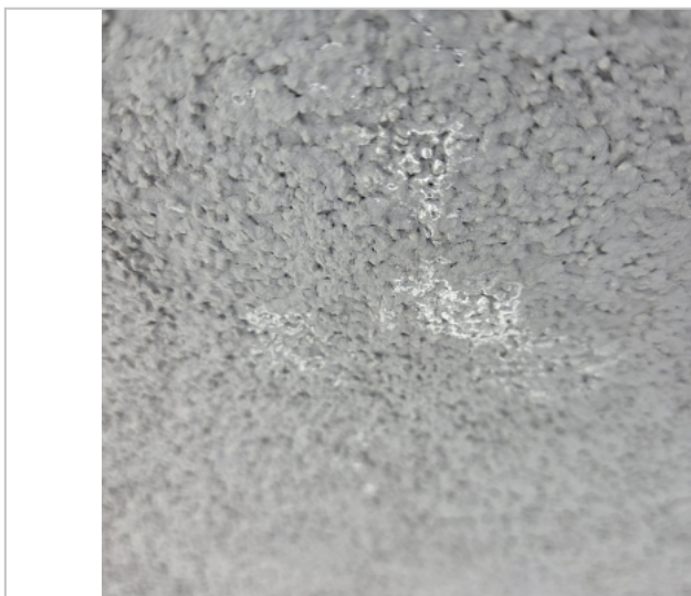
Foto: Boule a sanitr na podhledu u terasy
