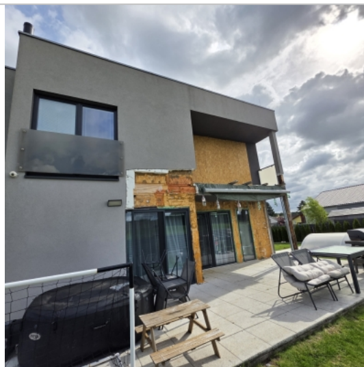
Foto: Rozsah poškození
