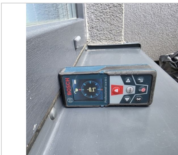
Foto: Nedostatečný sklon parapetu
