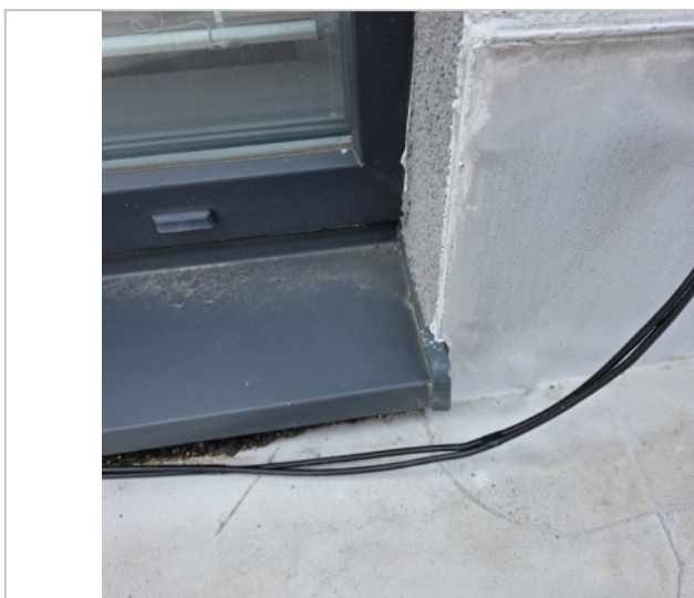
Foto: Nedostatečný výška hydroizolace nad po...
