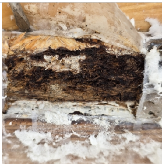
Foto: Masivní degradace pod parotěsnicí vrstvou
