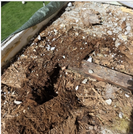
Foto: Masivní degradace dřevěné konstrukce
