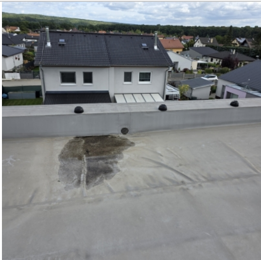
Foto: Tvorba louží a zvrásnění izolace
