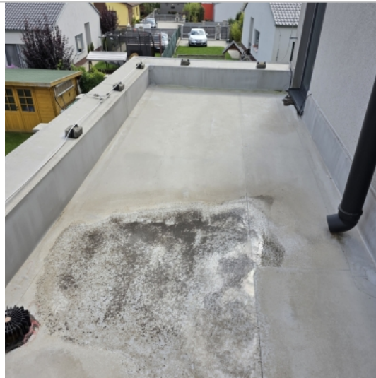
Foto: Tvorba louží na střeše
