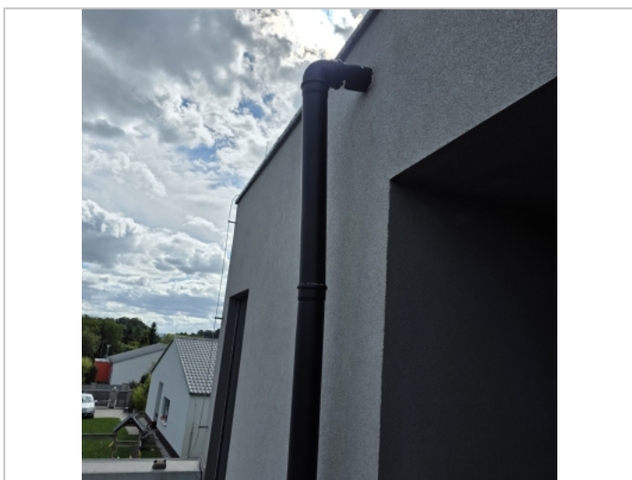
Foto: Nezajištěný svod
