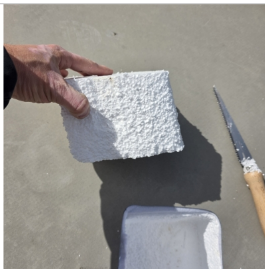
Foto: Tepelná izolace střechy - bez vlhkosti
