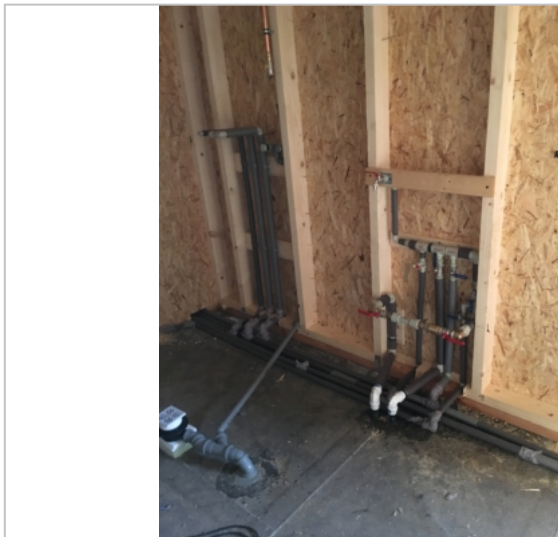
Foto: Rozvody vody
