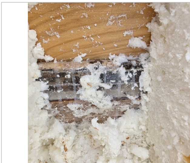
Foto: Obnažená parotěsnicí vrstva
