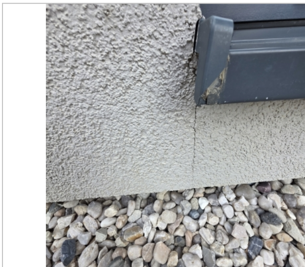
Foto: Deformace lišty
