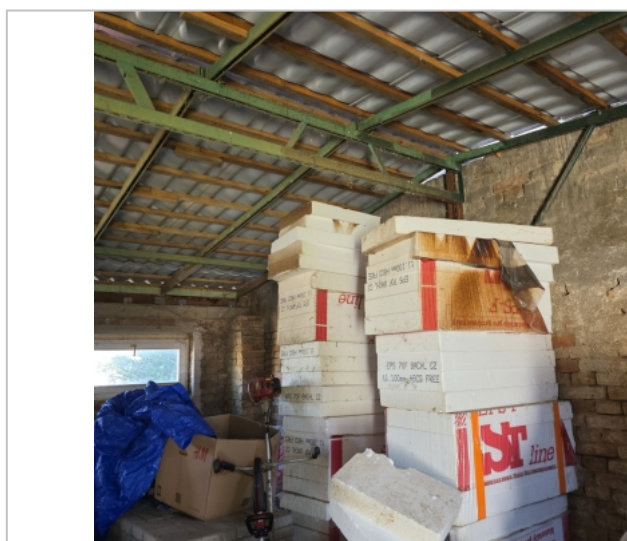
Foto: Absence zateplení u průjezdu
