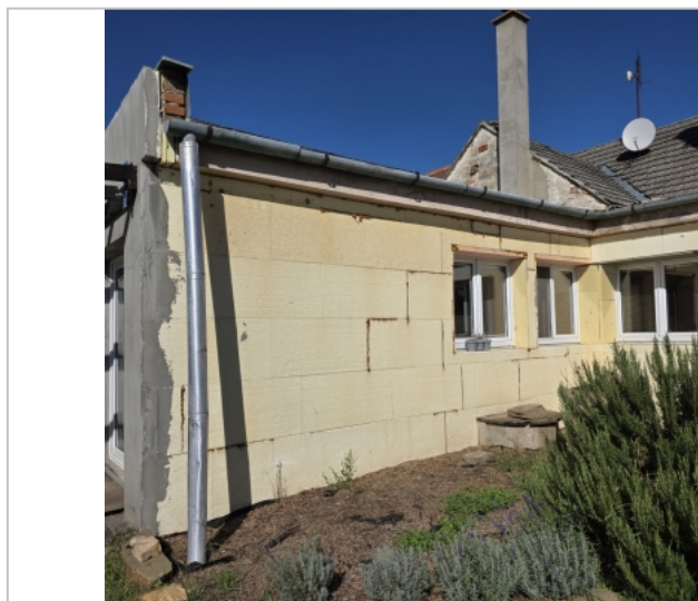
Foto: Zateplení jižní strany - degradace izolace
