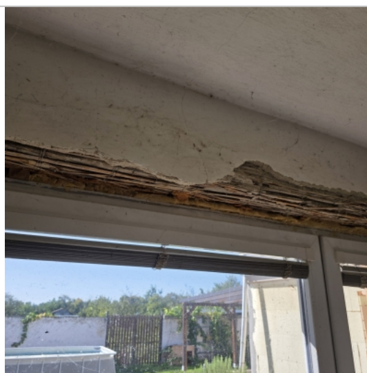
Foto: Detail dřevěného překladu
