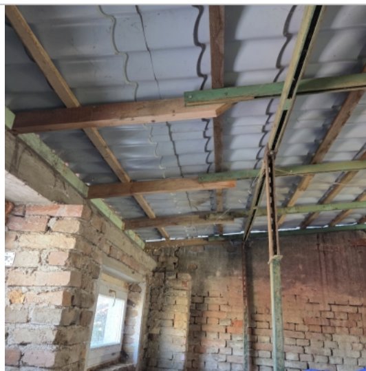
Foto: Nevhovující nosná konstrukce
