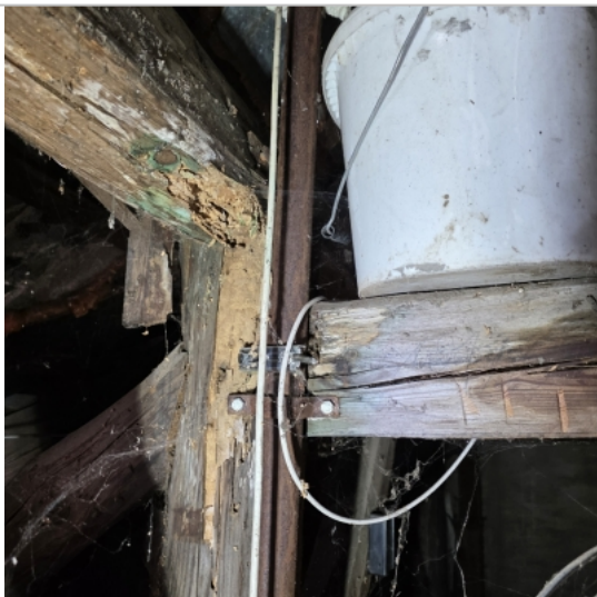
Foto: Masivní degradace dřevěné nosné konstr...
