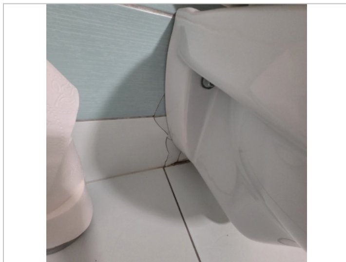
Foto: Poškození obkladu o WC
