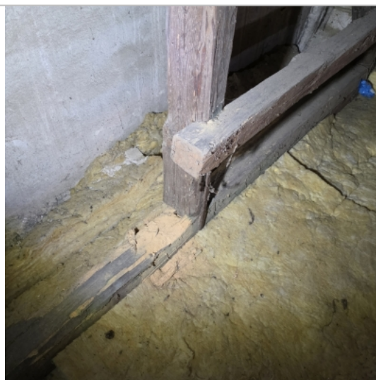
Foto: Masivní degradace dřevěné nosné konstr...
