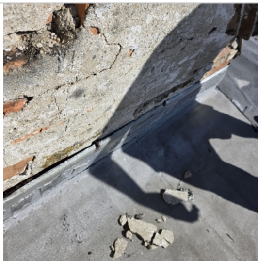
Foto: Netěsné napojení na stěnu
