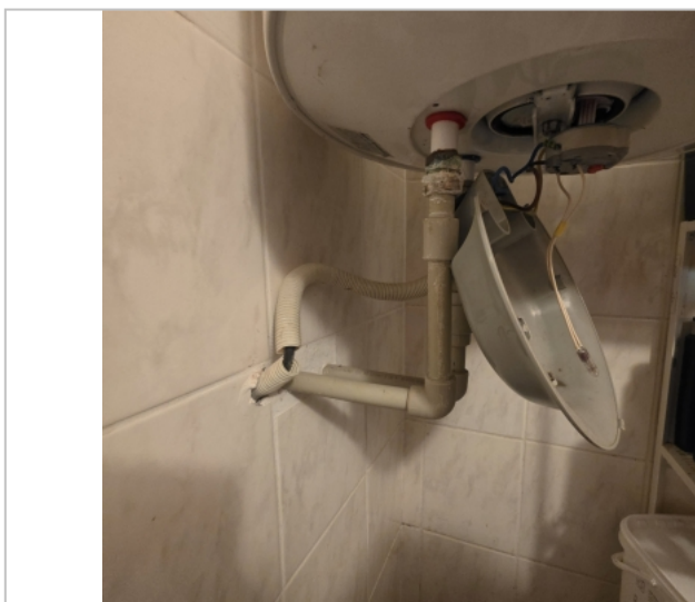
Foto: Absence zateplení, poškození bojleru
