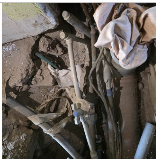
Foto: Rozvody vody v přístavbě
