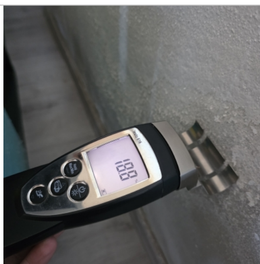
Foto: Hmotnostní vlhkost zdiva
