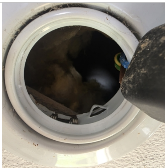
Foto: Netěsné provedení parozábrany u světla
