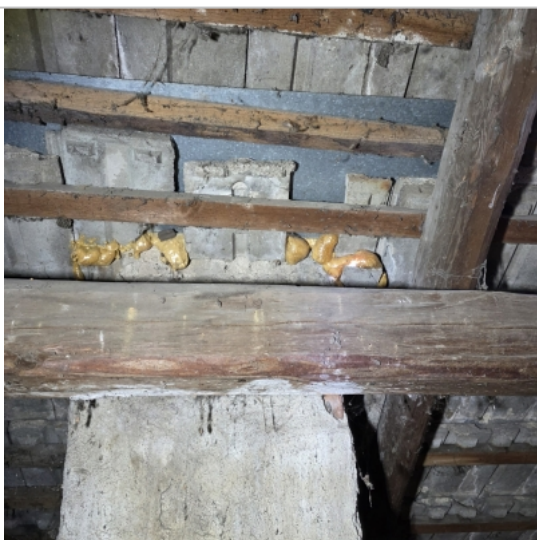
Foto: Netěsnosti v krytině - těsněno pěnou
