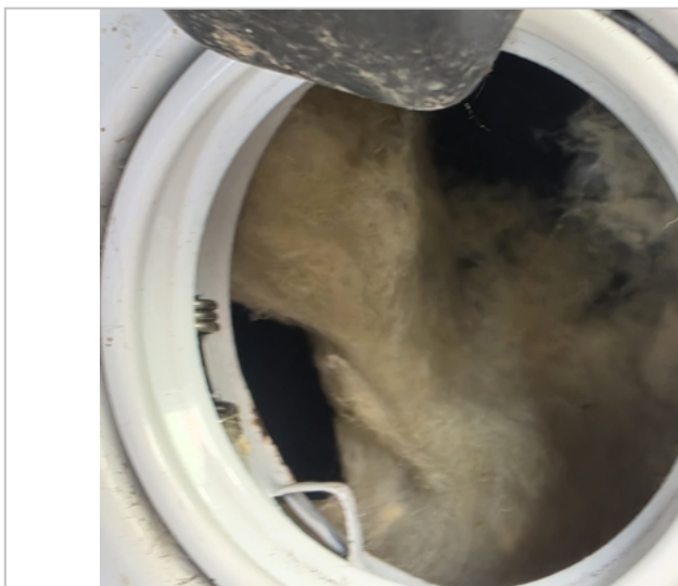
Foto: Netěsné provedení parozábrany u světla
