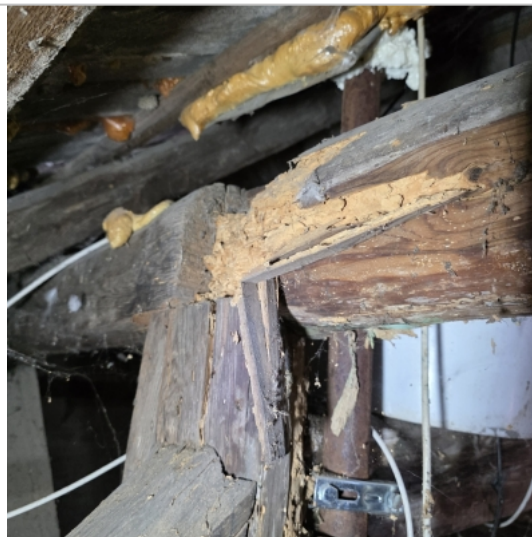
Foto: Masivní degradace dřevěné nosné konstr...
