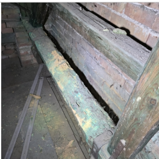
Foto: Masivní degradace dřevěné nosné konstr...
