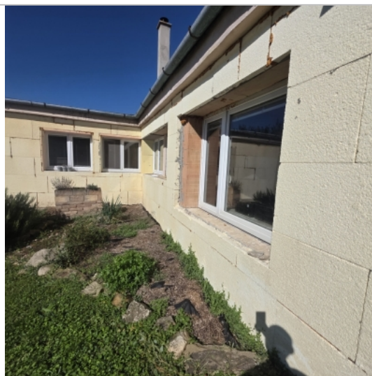
Foto: Absence parapetu
