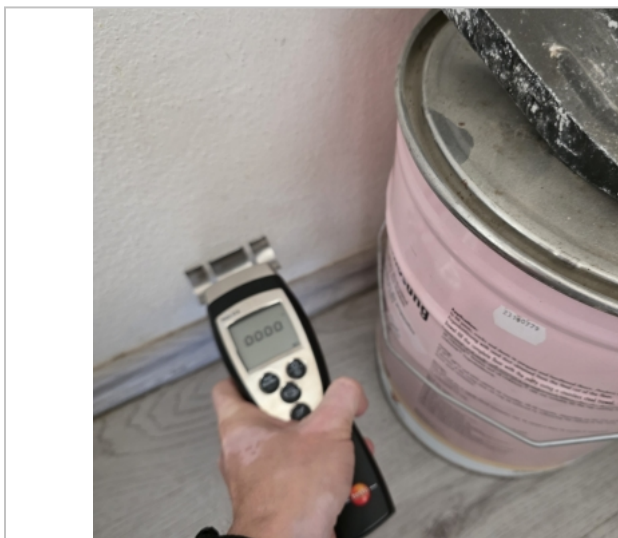
Foto: Hmotnostní vlhkost zdiva = >20%
