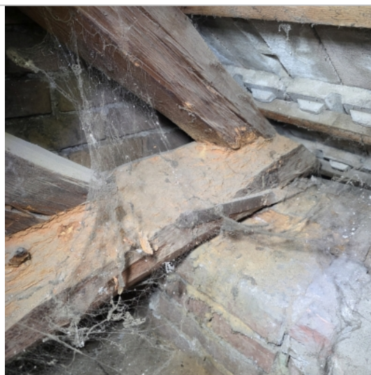
Foto: Masivní degradace dřevěné nosné konstr...
