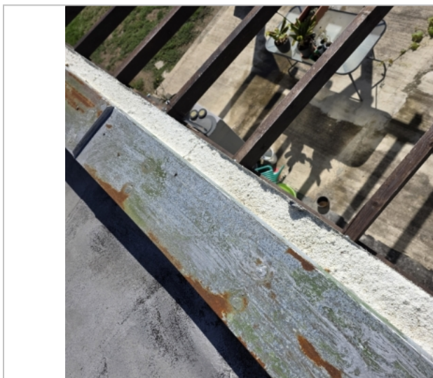
Foto: Nevhodné ukončení zateplení
