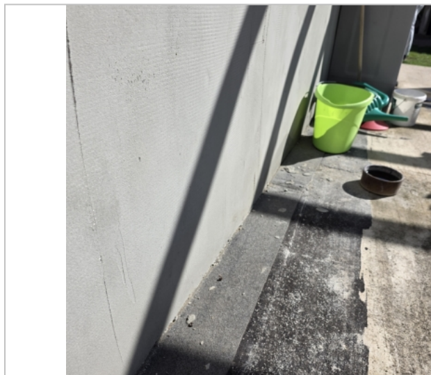
Foto: Hydroizolace u terasy
