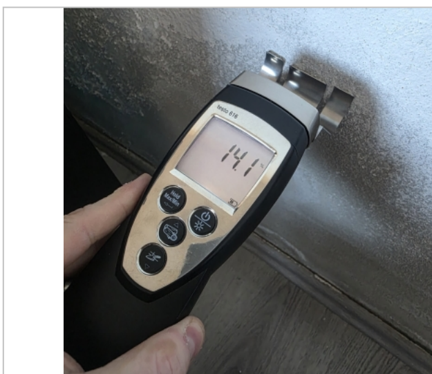
Foto: Hmotnostní vlhkost zdiva
