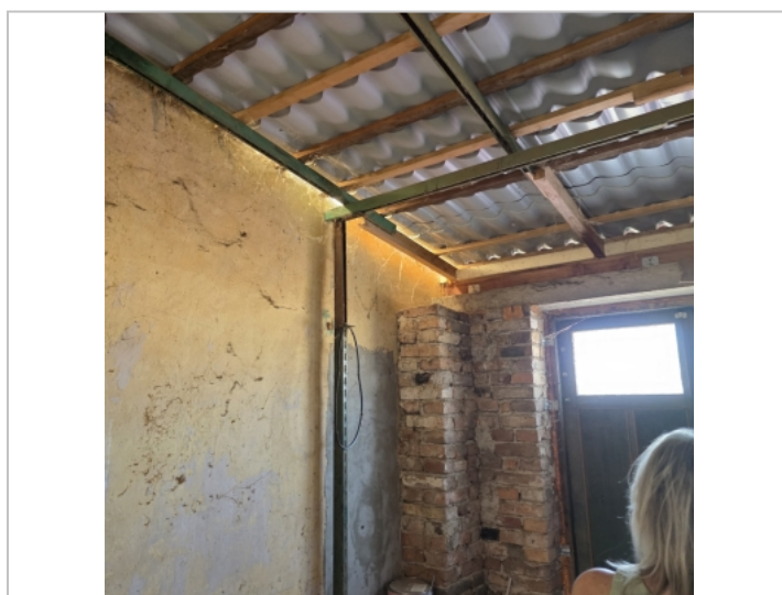
Foto: Absence zateplení u průjezdu
