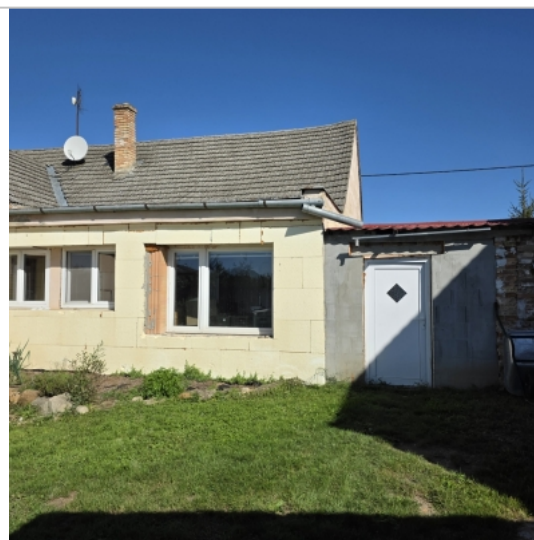
Foto: Degradace zateplení
