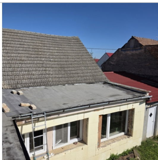
Foto: Původní žlaby, absence odvodnění střec...
