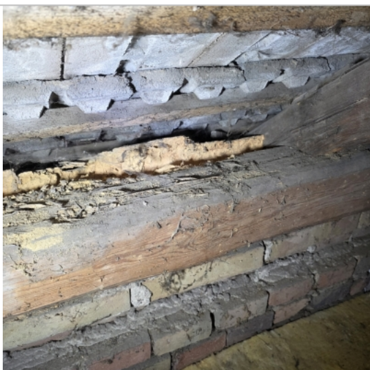
Foto: Masivní degradace dřevěné nosné konstr...
