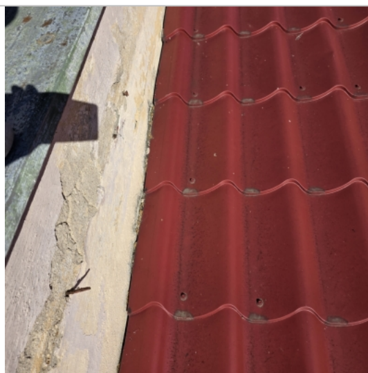
Foto: Netěsně napojení na stěnu
