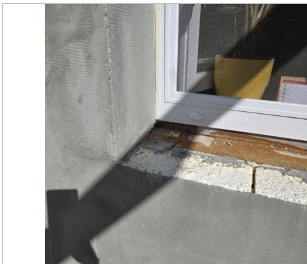
Foto: Absence parapetu
