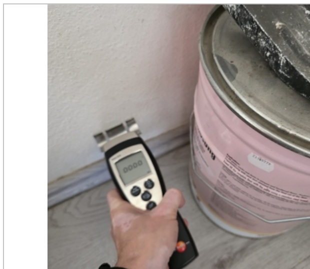
Foto: Hmotnostní vlhkost zdiva = >20%
