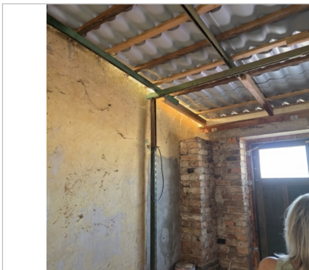
Foto: Absence zateplení u průjezdu
