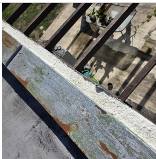
Foto: Nevhodné ukončení zateplení
