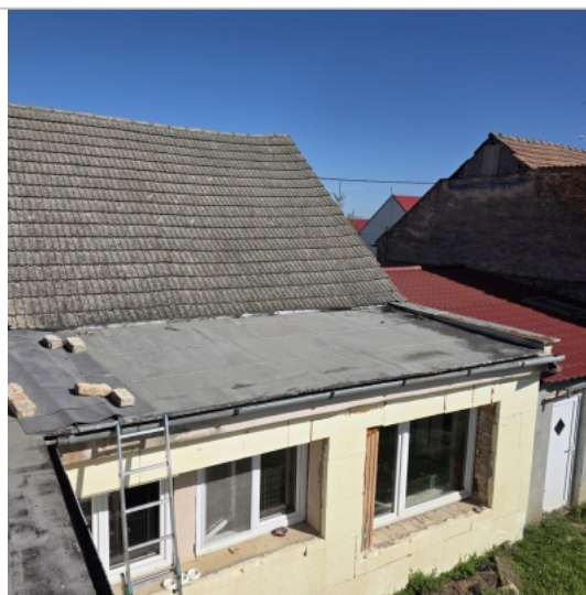
Foto: Původní žlaby, absence odvodnění střec...
