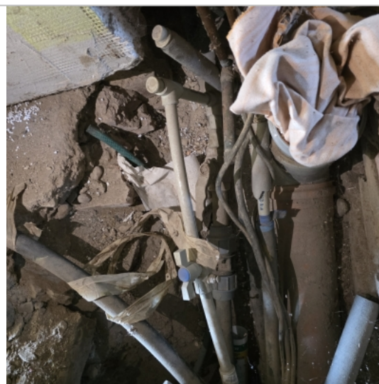
Foto: Rozvody vody v přístavbě
