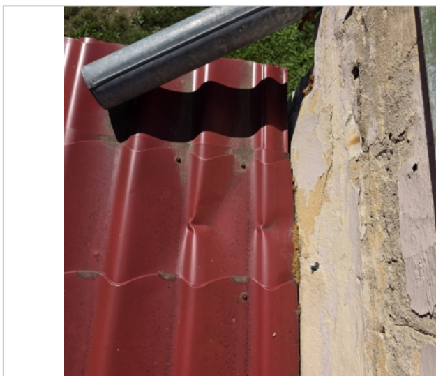
Foto: Netěsné napojení na stěnu
