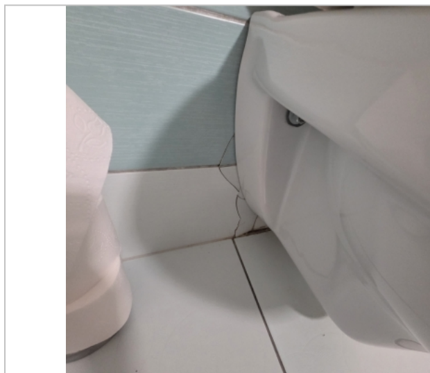
Foto: Poškození obkladu o WC
