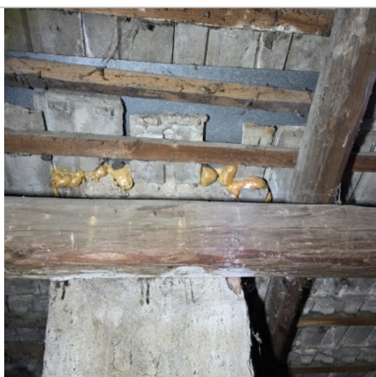
Foto: Netěsnosti v krytině - těsněno pěnou
