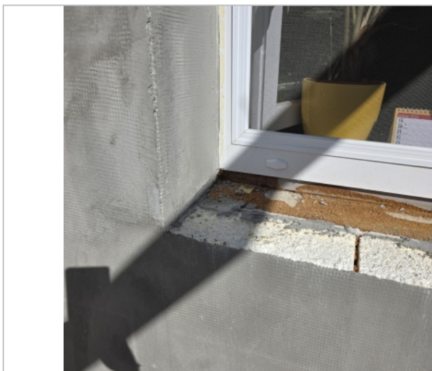
Foto: Absence parapetu
