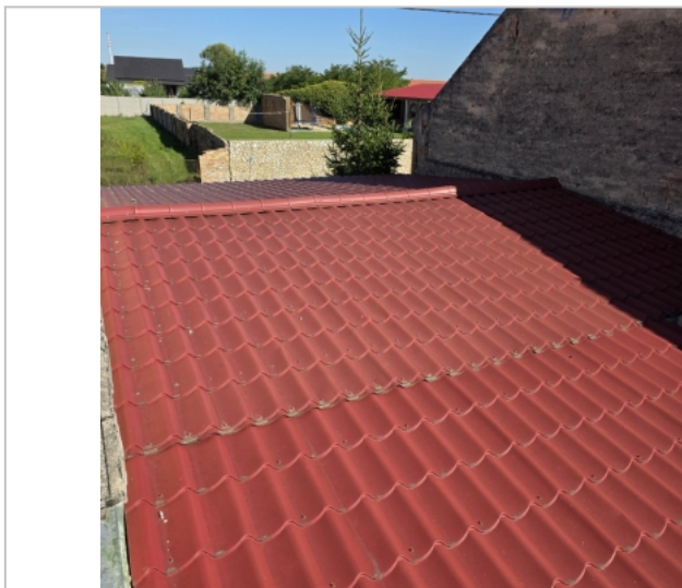
Foto: Střecha nad průjezdem
