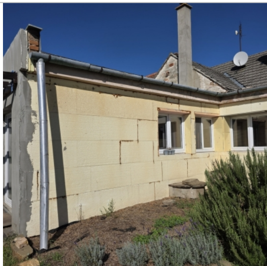
Foto: Zateplení jižní strany - degradace izolace
