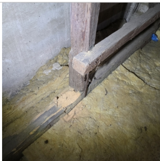
Foto: Masivní degradace dřevěné nosné konstr...
