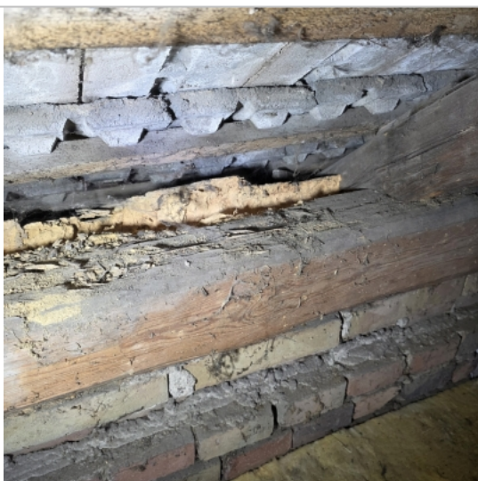
Foto: Masivní degradace dřevěné nosné konstr...
