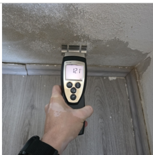
Foto: Hmotnostní vlhkost zdiva
