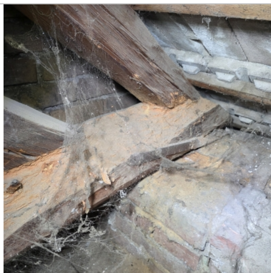
Foto: Masivní degradace dřevěné nosné konstr...
