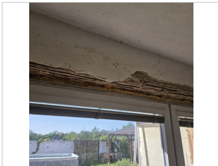
Foto: Detail dřevěného překladu
