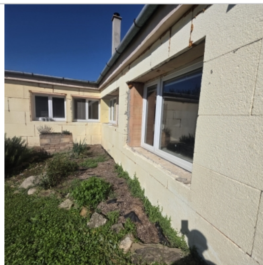
Foto: Absence parapetu
