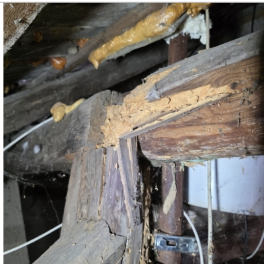
Foto: Masivní degradace dřevěné nosné konstr...
