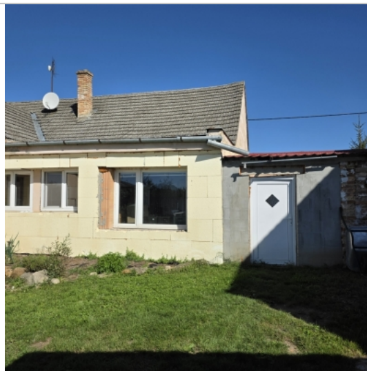
Foto: Degradace zateplení
