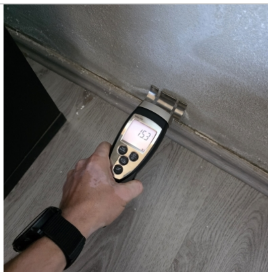
Foto: Hmotnostní vlhkost zdiva
