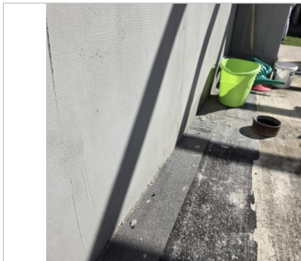
Foto: Hydroizolace u terasy
