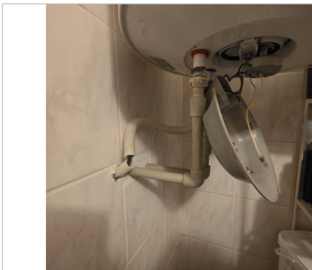
Foto: Absence zateplení, poškození bojleru
